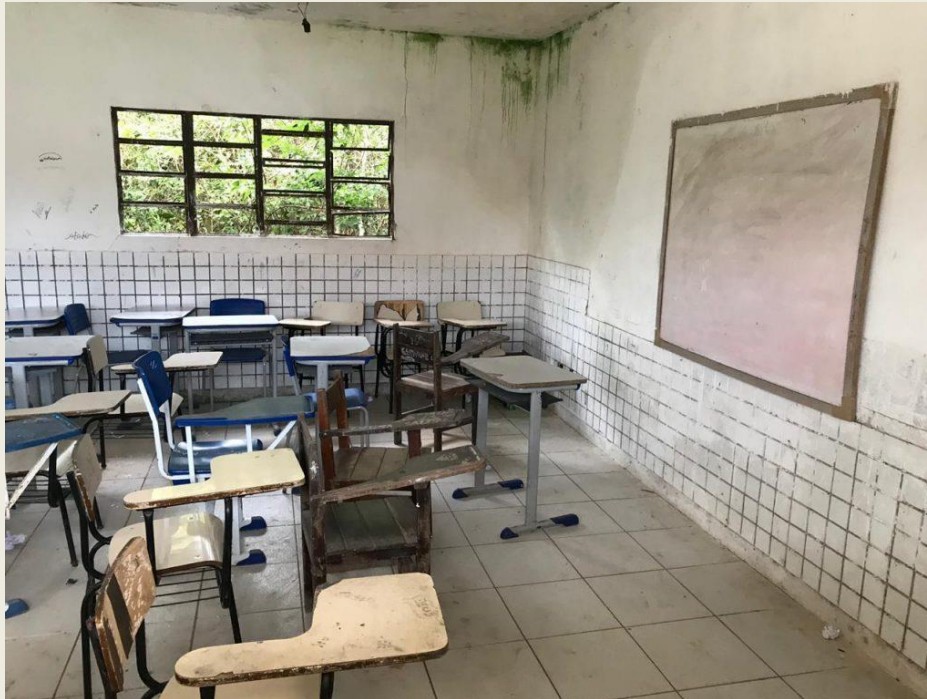
Sala de aula sem ventilação e até lodo na parede
